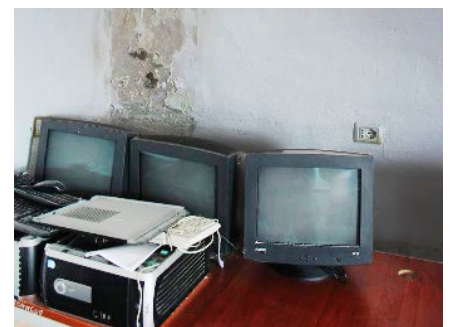
Vorher: Wasser an den Wänden statt funktionierender PCs
