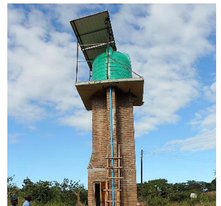
Die solarbetriebene Wasserversorgung
